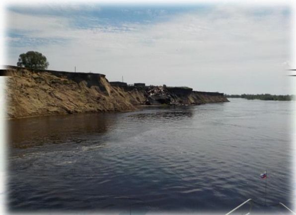
Обрушение берега (улицы) в п. Тымск в период весеннего половодья
